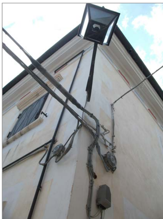
FOTO 12: cavi a vista in un vicolo di via Battisti
